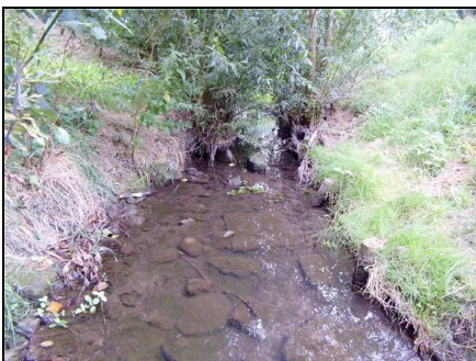
Abb. 1: Vor der Maßnahme: Zugesetztes Gewässerbett, 13.08.2015
