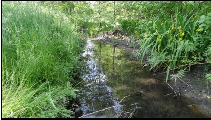
Abb. 2: Vor der Maßnahme: Verschlämmlung im renaturierten Abschnitt, 23.05.2017
